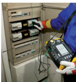
Mantenimiento terciario e industrial, diagnósticos y controles
